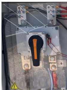
Abbildung 6: Beispiel für den Freiraum zwischen den Eingangskabeln in einem TELERGON-Lasttrennschalter.
